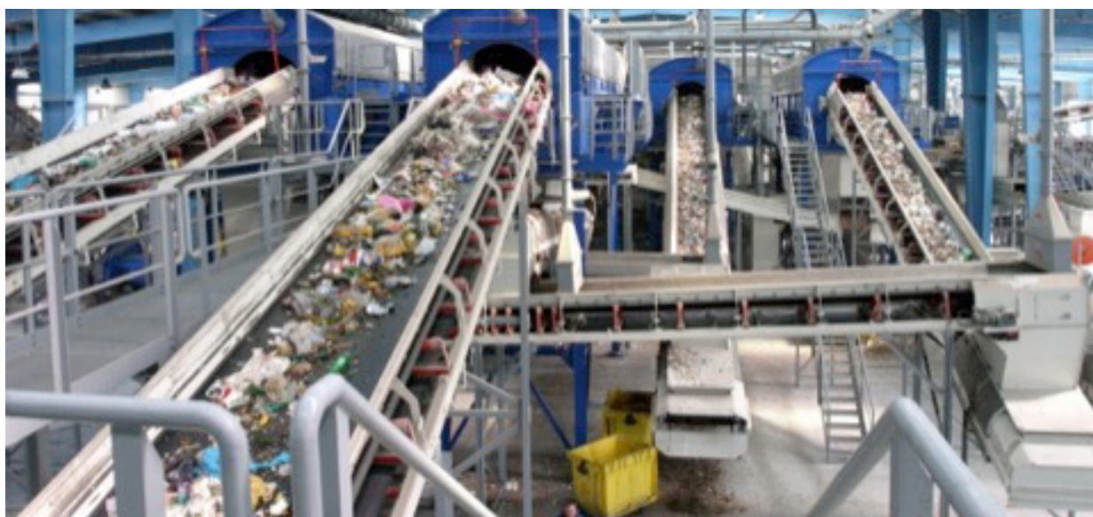
Figur 4: Sentralsorteringanlegget på ROAF. Bildet er hentet fra Kretsløpet.no
