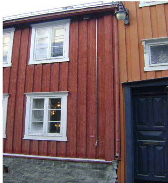
Figur 28: Utvendig rørføring på bygning.
