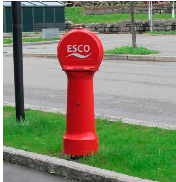
Figur 10: Hydranter er lettere å finne enn brannkummer og raskere å koble til.
