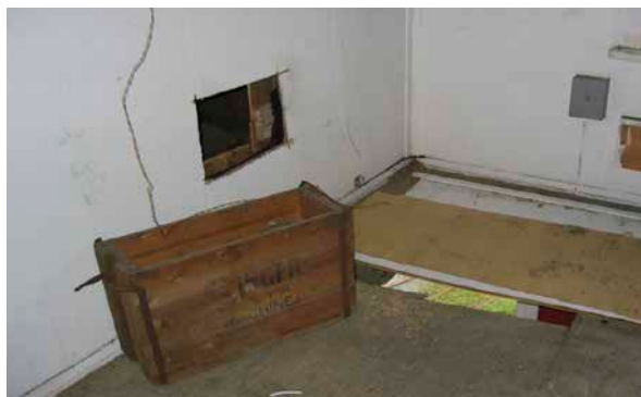
Figur 40: Fra andre etasje og opptil loftet var det saget et hull på ca 1 m2. Dette kunne spre brannen fritt opp på loftet, men vanntåken hindret overtenning så lenge vannet ble påført.
