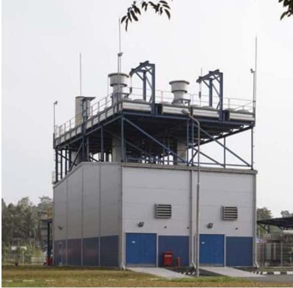
Figur 78: eksempel på permanent gasskraftverk som dekker effekter opp til 13,9 MW
